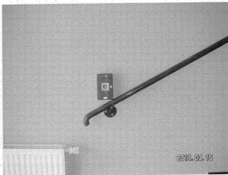
Fot. 6 – Przycisk przeciwpożarowego wyłącznika prądu usytuowany w wiatrołapie klatki schodowej „A” przy głównym wejściu do budynku.
