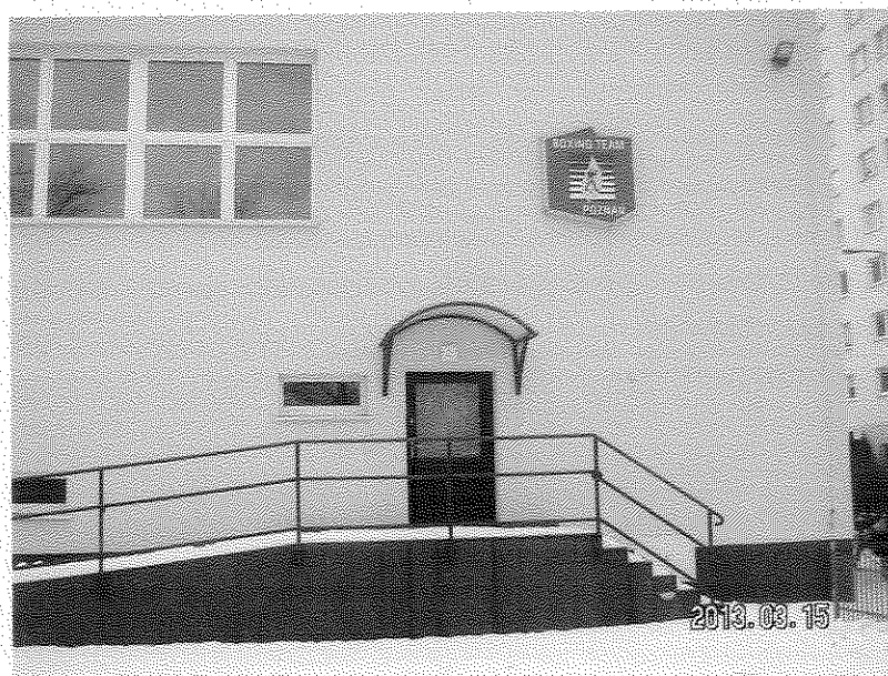
Fot. 2 – Fragment elewacji bocznej lewej z widocznym wejściem do klatki „B”. Szerokość drzwi zewnętrznych wynosi 90 cm w świetle, wobec szerokości KA
